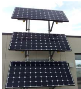
写真1 太陽光発電パネル
